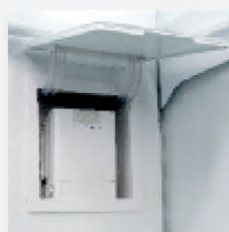
Система очистки воздуха.
